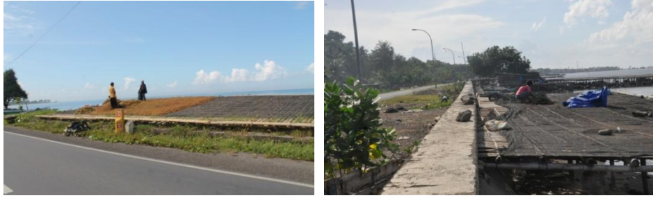
Gambar 1. Kondisi bahu jalan dan ruang sempadan pantai dipergunakan untuk kegiatan petani rumput laut di sepanjang pantai \pm 32 km, rawan kecelakaan
