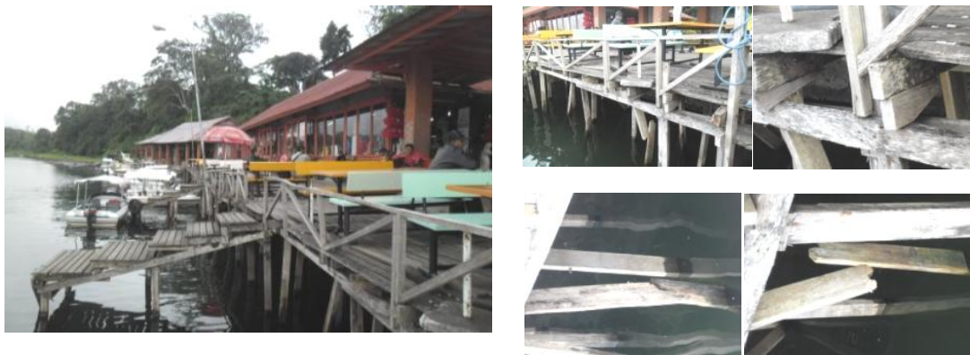
Gambar 3 Kondisi dermaga di Danau Batur, Bali
