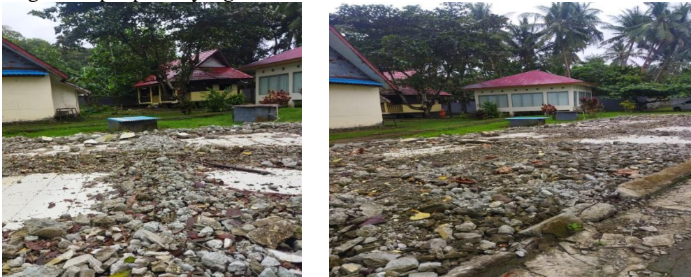
Gambar 4. Kondisi tempat dulunya merupakan gedung serbaguna dan kemudian rencananya akan diubah menjadi tempat parkir
