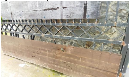
Gambar 1. Pintu gerbang masuk harus diperbaiki lagi agar terlihat bagus
