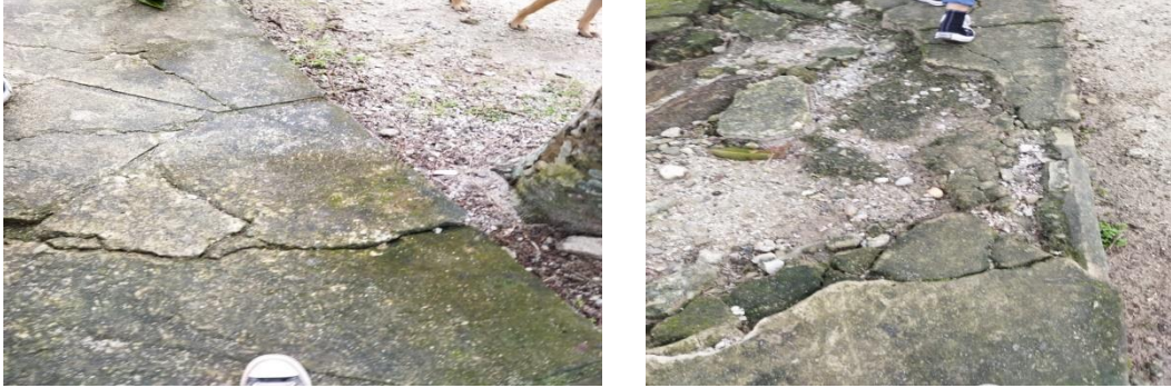
Gambar 9. Akses jalan untuk pejalan kaki sudah rusak
