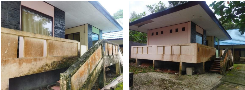
Gambar 2. Foto kondisi kantor perlu dibersihkan agar terlihat lebih rapih apalagi letak kantor bersebelahan dengan pintu masuk
