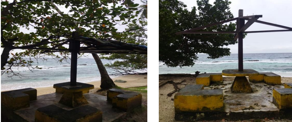
Gambar 6. Gazebo di namalatu beach perlu diperbaiki lagi karna atap dari gazebo sudah rusak semuanya.
