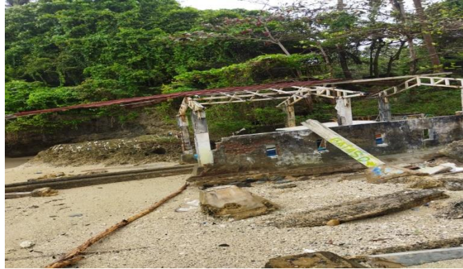
Gambar 12. Tempat perahu sudah rusak perlu diperbaiki lagi
