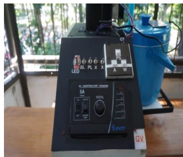
Gambar 7. Ruang Catu Daya dan controller
