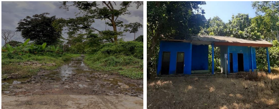
Gambar 5. Kerusakan Jaringan Jalan dan Toilet di Pantai Bandalit Sumber: Survey Primer, 2021
