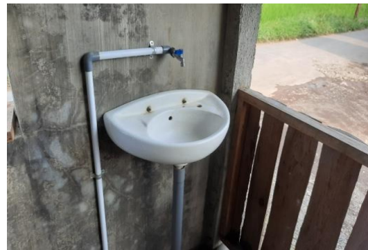
Gambar 1. Sarana Cuci Tangan yang Tidak Lengkap
