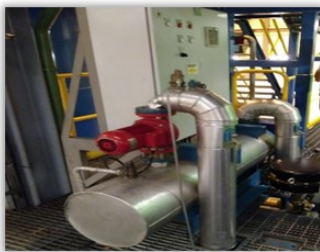
Gbr. 1 Preheater Electric (Sumber: Dok PLTDG Pesanggaran)
