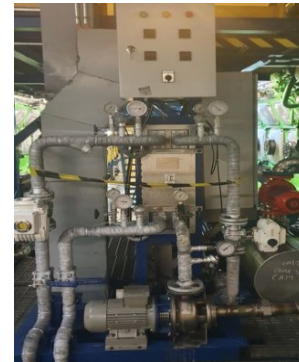
Gbr. 3 Preheater Thermal (Sumber: Dok PLTDG Pesanggaran)
